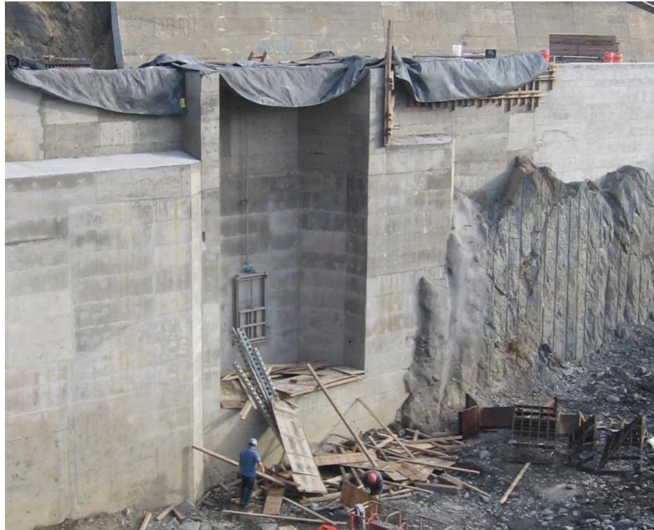
Figure 3 : Photographies durant les travaux de réfection du barrage et de la prise d'eau en 2012
